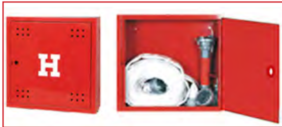
Foto nr.48 Hidrant i brendshëm në mur
