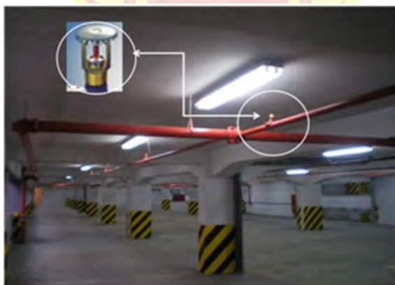
Слика бр. 17. Гаража со автоматски систем за гаснење пожар „спринклер“
